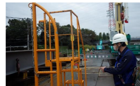
トラックの荷台への昇降設備(令和5年10月施行の改正に関連)の確認を行う平塚署署長
